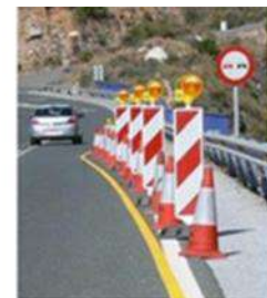
Luces amarillas fijas o intermitentes (sobre balizas de borde provisionales)
